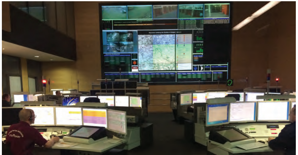
Ein Blick in die Integrierte Leitstelle für Sicherheit und Mobilität der Stadt Stuttgart (SIMOS)
