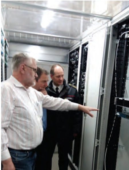
Einbau der Konzentratortechnik in der Leitstelle Villingen-Schwenningen. V.l.n.r.: Klaus Schwab (T-Systems), Harald Bloching (Innenministerium) und Kreisbrandmeister Florian Vetter (LRA Schwarzwald-Baar-Kreis)
