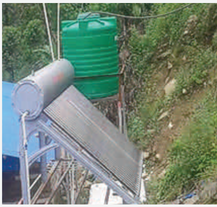
Wassertank und Solarplatte Bildnachweis: Malteser International
